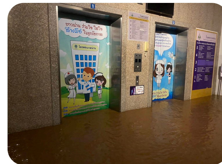
ตั้งและดูแลลิฟต์โดยสาร อาคารสำนักงานโรงพยาบาล
