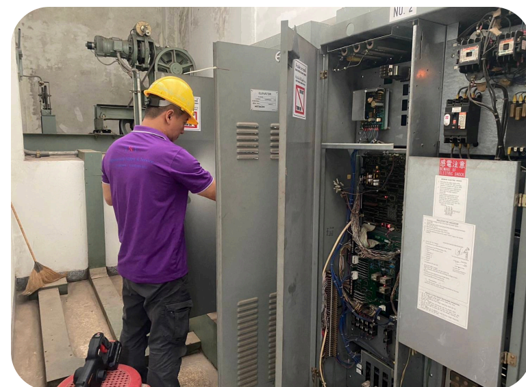
ติดตั้งและดูแลตู้ MDB อาคารสำนักงาน
